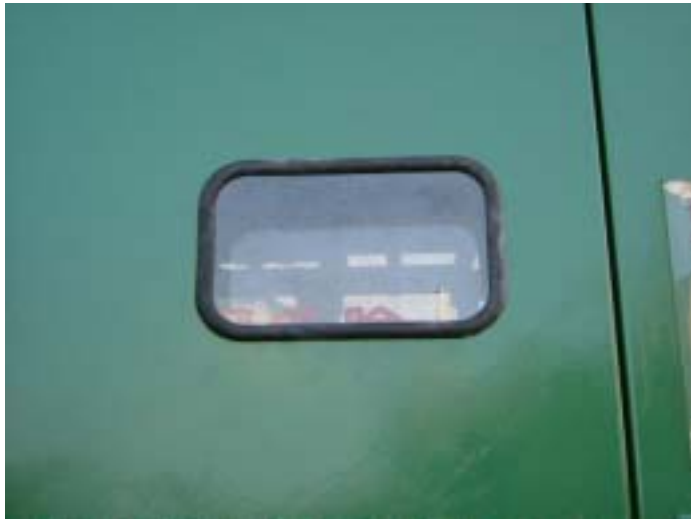
DS盤體透視窗修復照片
